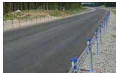
شکل ۱ - نمونه‌ای از حفاظ کابلی اجراشده
